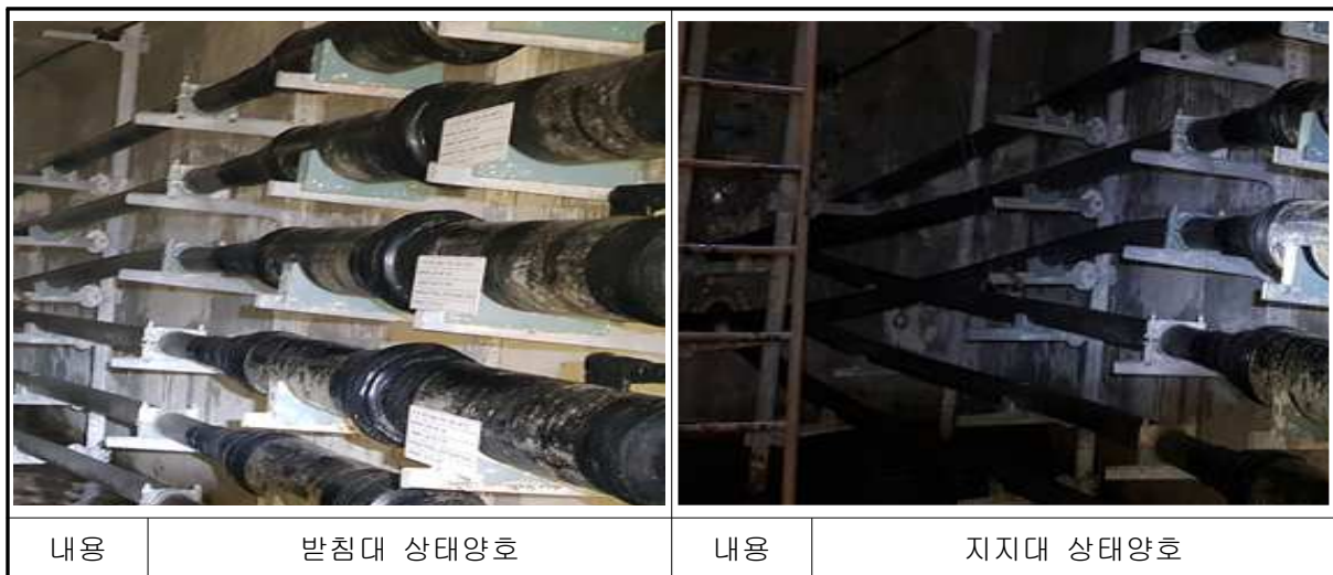
【사진 10.25】 부속 및 부대설비 현황
