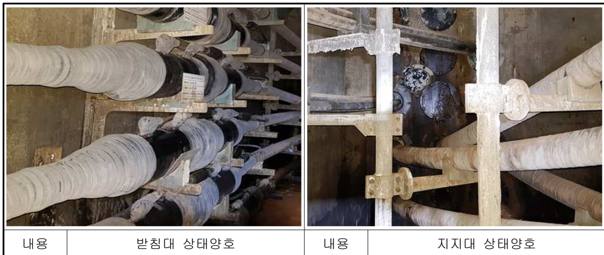
【사진 10.9】 부속 및 부대설비 현황
