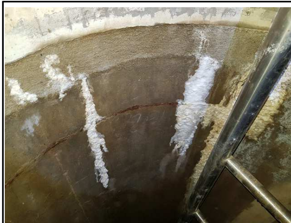
내용 맨홀 수직부 내부 벽체 백태
